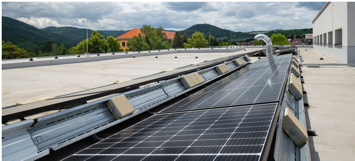
Střešní fotovoltaická elektrárna
